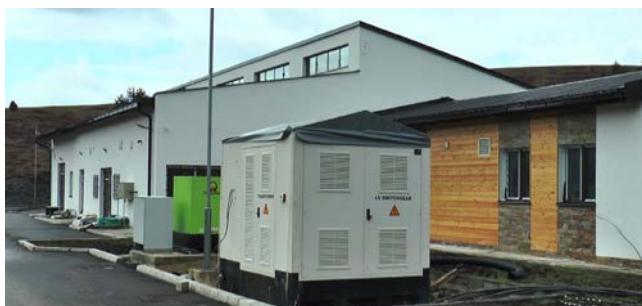
На постројењу за прераду отпадних вода постављена је електромрежа, као и трафостаница
